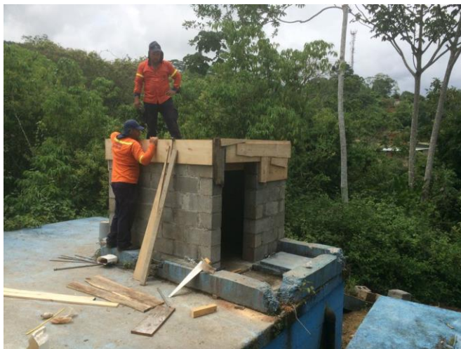
Construcción de casetilla para refuerzo de cloración sector de Campabadal, San Cayetano y el INA.
